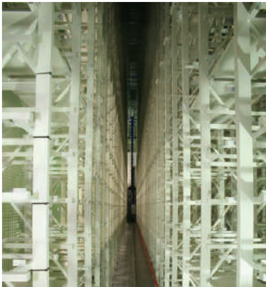
● 4990 ชั้นได้ถูกติดตั้งเพื่อประหยัดพื้นที่
